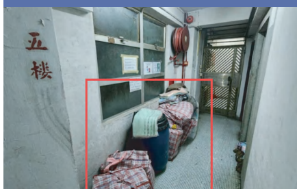
消防通道占用
