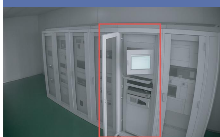
设备未正常关闭
